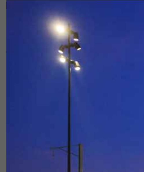
Poteaux d'éclairage avec spots, Winterthur
