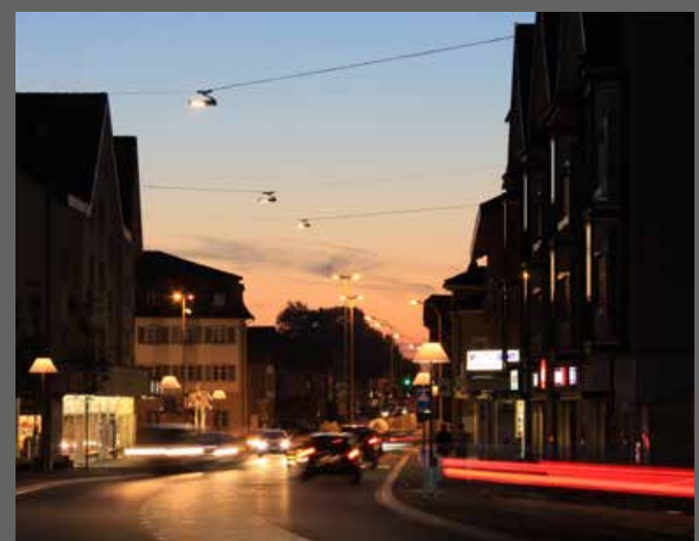
Luminaire sur câble METRO, Winterthur
