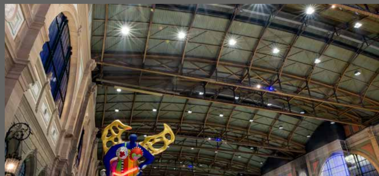
Luminaire spécial HUB, gare centrale de Zurich
