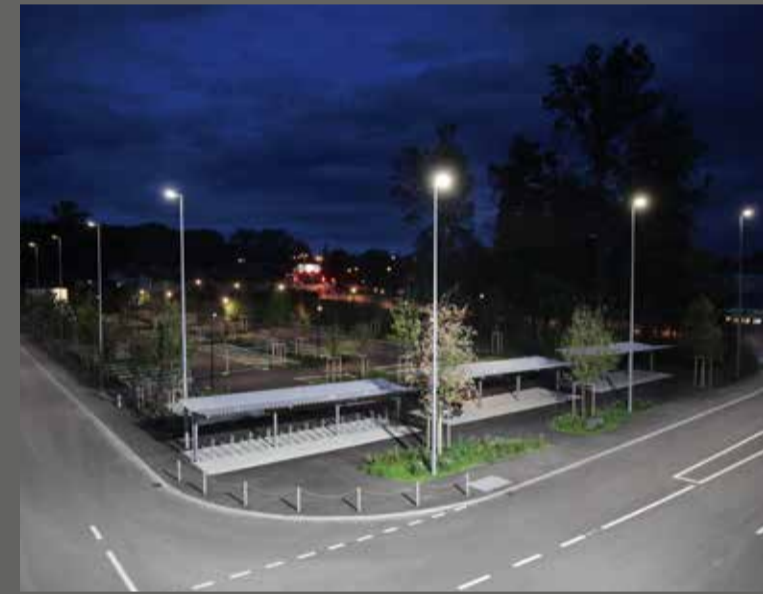
Éclairage public METRO, centrale énergétique Forsthaus, Berne
