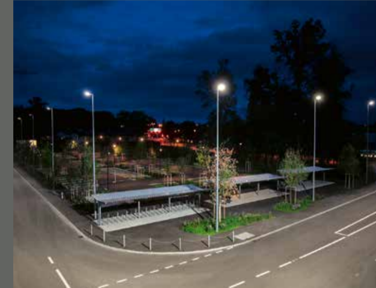
Strassenbeleuchtung METRO, Energiezentrale Forsthaus, Bern
